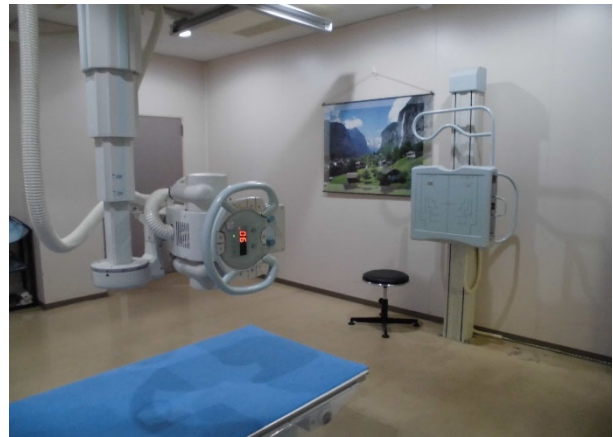
南大牟田病院 一般撮影検査室
